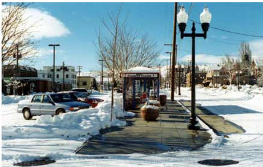
Figura 20. Marciapiede liberato dalla neve con un sistema di riscaldamento geotermico a Klamath Falls in Oregon (USA). L'acqua calda circola in tubi posti sotto la pavimentazione.
